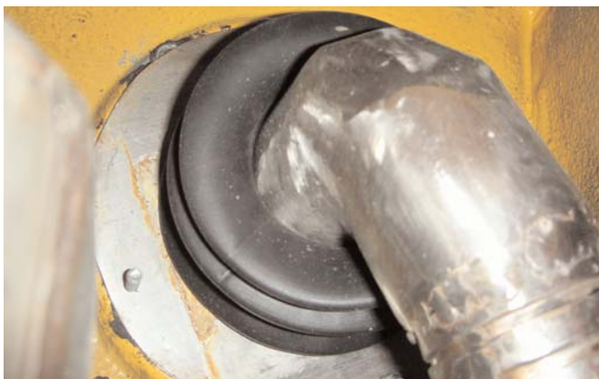
Übergang des V2A-Rohr zum Sportluftfilter
